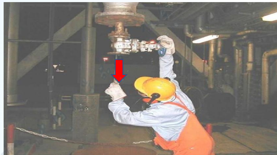
清理物料，未避开物料火线！
