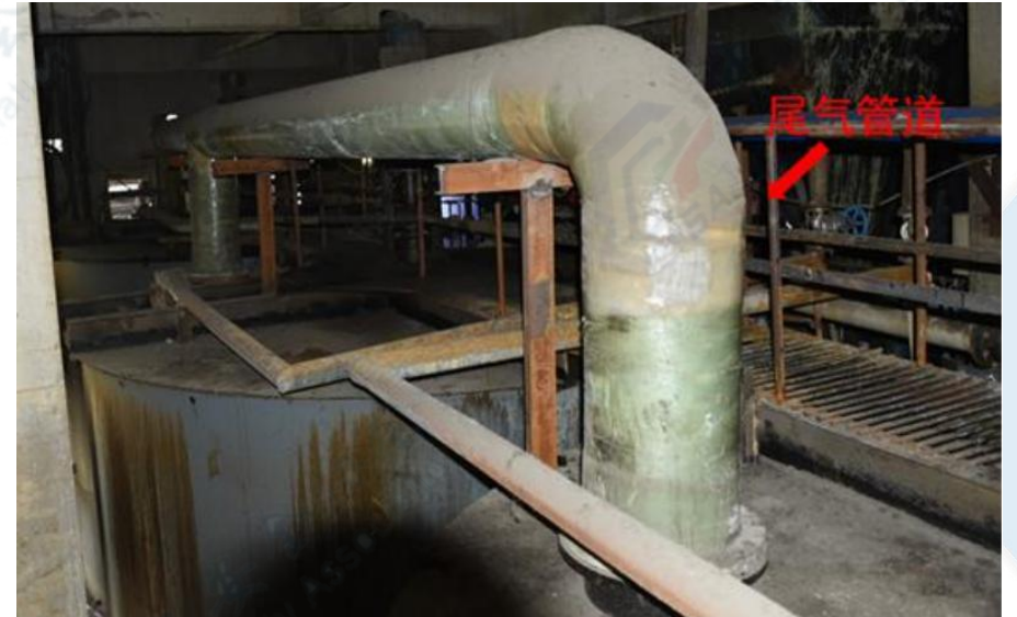
3座泥浆桶尾气管道相互联通
