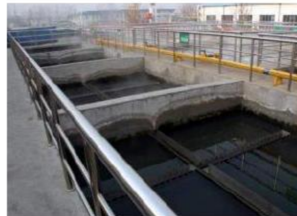
(f) 污水处理池
