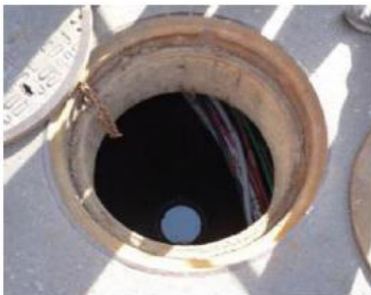
(d) 电力电缆井
