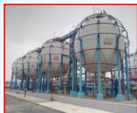
重大危险源罐区
